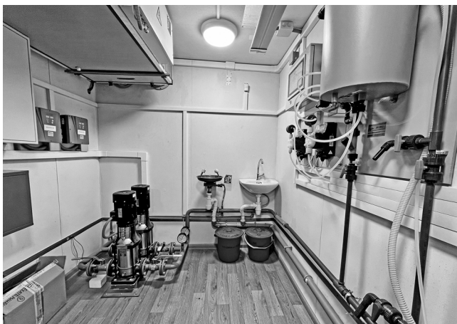
Станция с оборудованием по выработке диоксида хлора.
